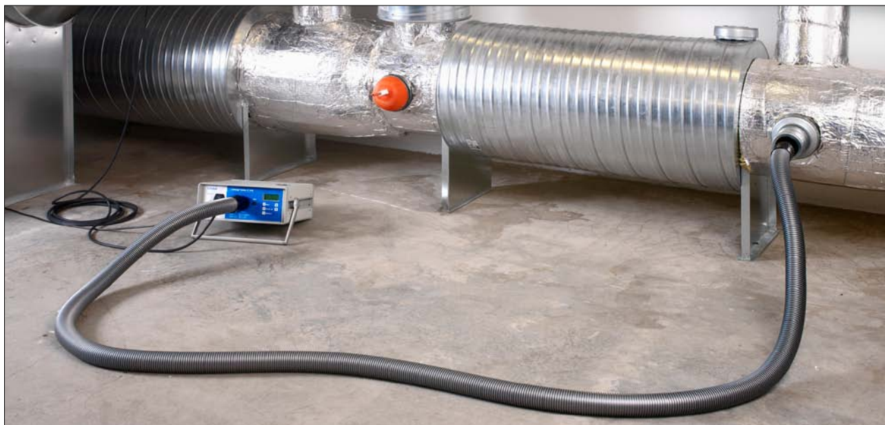
Bild 3: Anslutning till kanalsystemet
