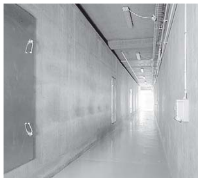
Langs den 3 x 3 meter store ventilationskanal i underetagen er der en gang med adgang til de 4 lyddæmpere og ventilatoren.
