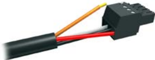
Figur 1. Kabel från VAV-spjäll/Belimo-motor där ledare 5, orange, är frånkopplad.
