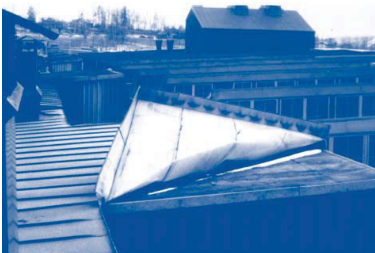
Hibásan rögzített síklemmezfedés szélszívás okozta tönkremenetele
