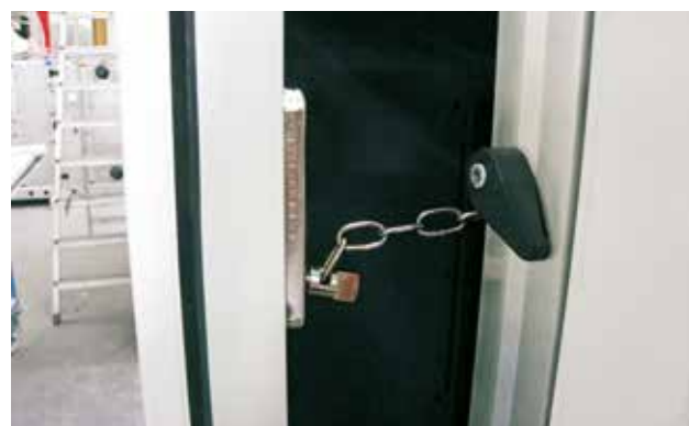
Bild 23: Alla övertrycksluckor är dessutom säkrade med en kedja.
